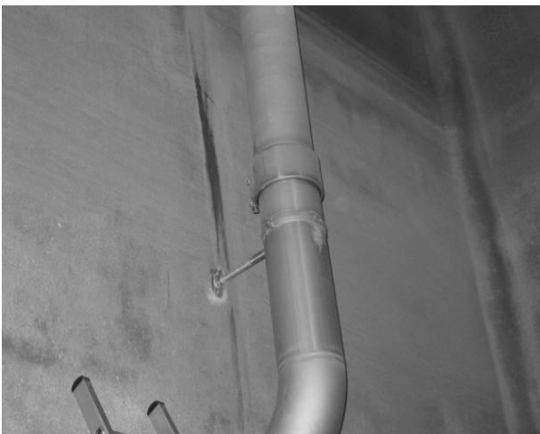
Abb. 2.12 Makroelement Bewehrung-NRST. Makroelementströme sind die mögliche Ursache der Korrosionsspuren auf der Betonoberfläche (Anode = Bewehrung, Kathode = Leitung aus NRST).
