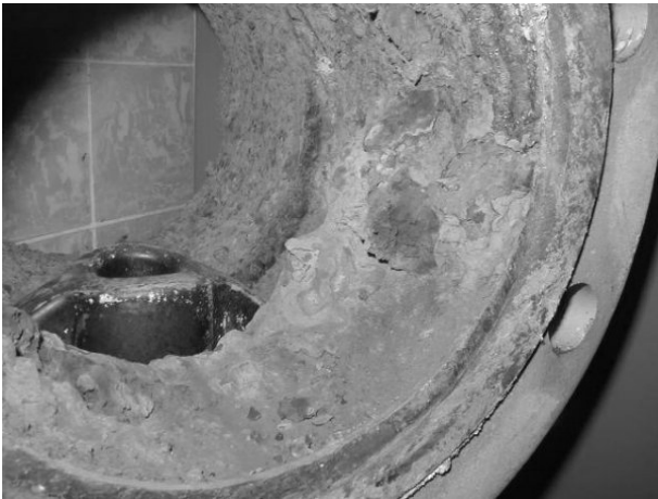
Abb. 2.5 Korrosion im Schieber
